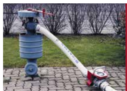
• Durchflussmengenmessung am Überflurhydranten.
