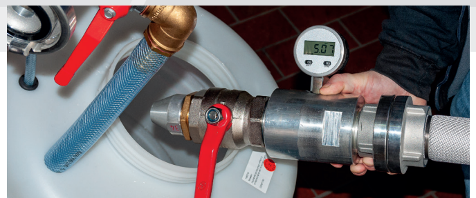
• Hydrantenprüfset HPS 2.0 im Einsatz.
